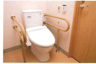
居室トイレ(利用者様用)
